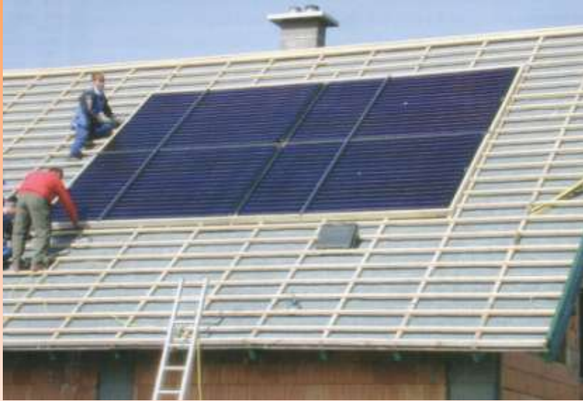
Integrazione dei collettori in un tetto ventilato
