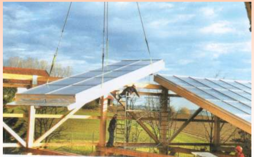
Collettori che realizzano la copertura
